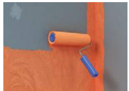
Abb. 6: Sicherstellung der Abdichtung für die Wasser- einwirkungsklassen W1-I und W2-I. fermacell™ Flüssigfolie mit der Rolle mind. 2 × vollflächig auftragen (Trockenschichtdicke mindestens 0,5 mm). Gemäß DIN 18534-3 wird für den 2. Auftrag ein Farbunterschied zur besseren Nachvollziehbarkeit gefordert. 1. Auftrag: fermacell™ Flüssigfolie in Originalfarbe satt auftragen und trocknen lassen
