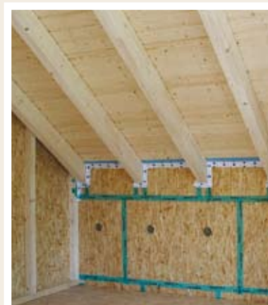
Pro Gefach wurde in die zu dämmende Außenwand während der Vorfertigung eine Einblasöffnung mit einem Durchmesser von 85 mm gebohrt, die nach dem Verfüllen des Rockwool Granulats mit dem Klebepflaster Ampacoll Profix der Firma Ampack verschlossen wurde. Zum Abkleben der stumpfen Stöße wurde das Klebeband Ampacoll I.N.T. verwendet.
